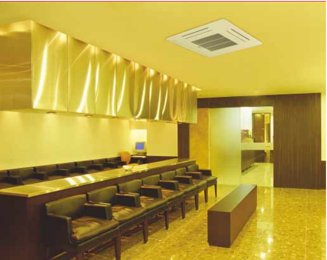
Multi splitové klimatizační jednotky
